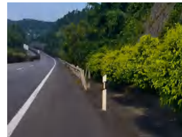
图3-3 K2076+319~K2100+322段路侧钢护栏端部现状
